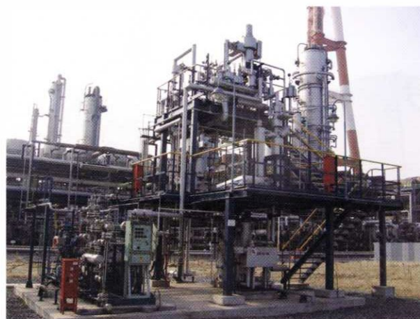
写真1 炭酸ガス分離回収設備外観
