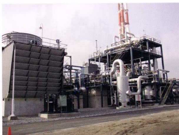
写真2 液化炭酸ガス製造設備外観
