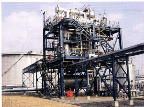
写真3 LNG冷熱回収設備外観
